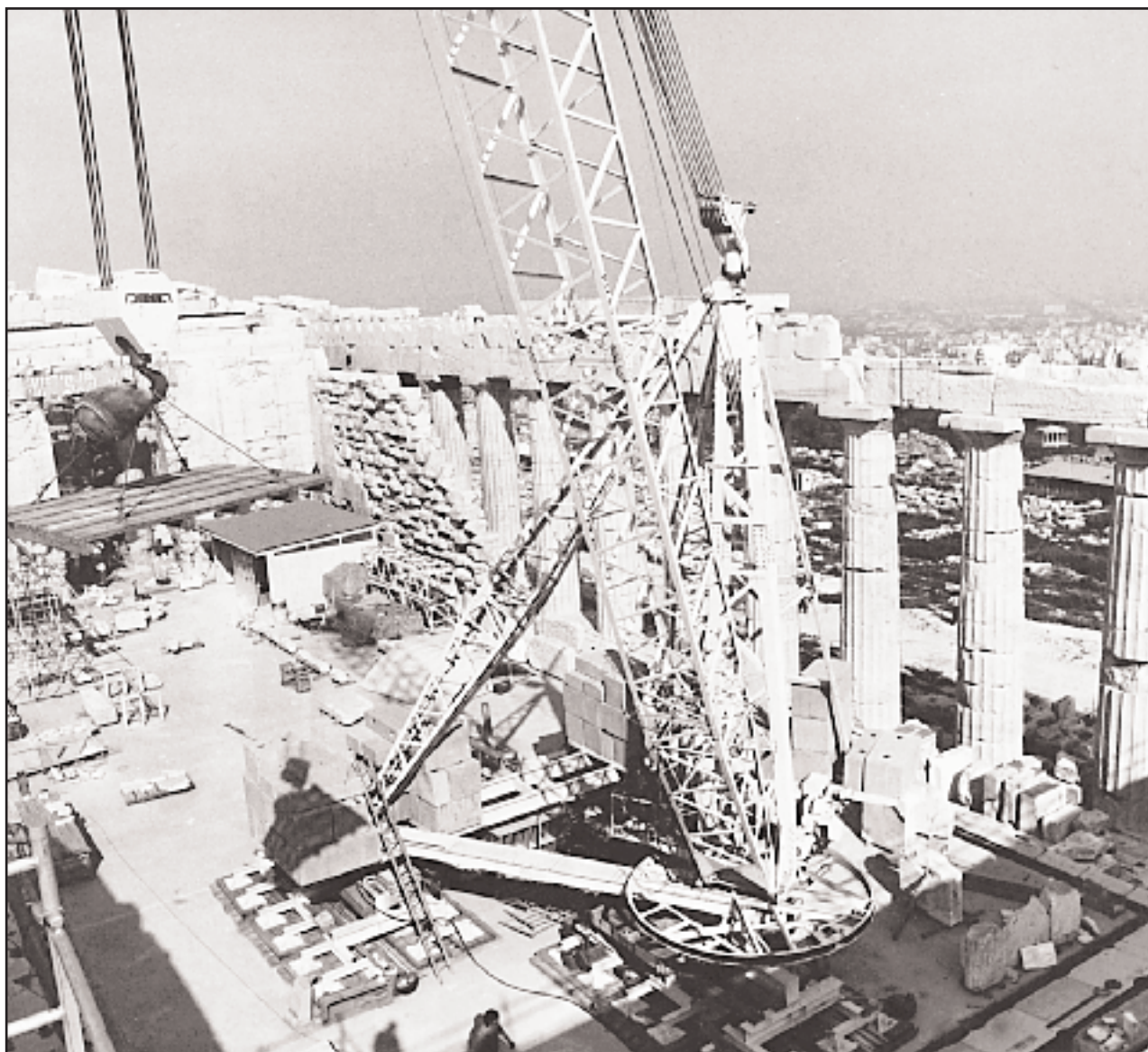
Ο μόνιμα εγκατεστημένος στο εσωτερικό του Παρθενώνα μεγάλος γερανός.
